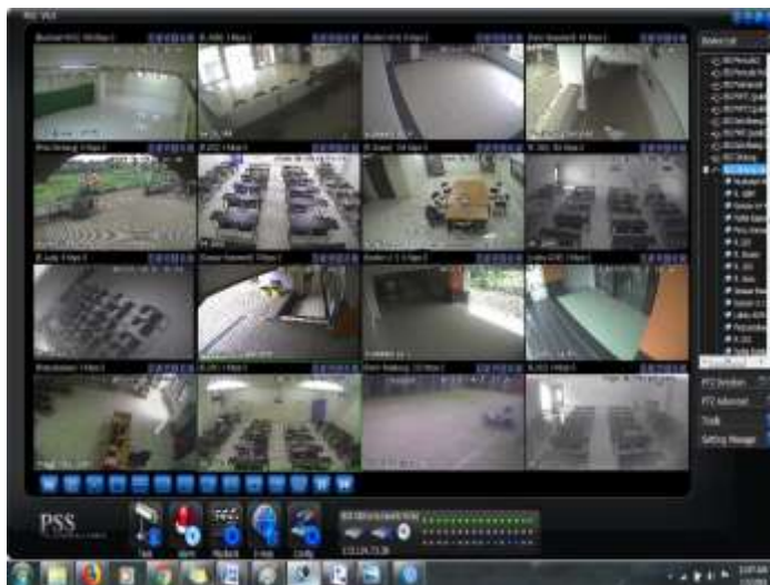
Gambar 6. Monitoring CCTV BSI Cibitung
